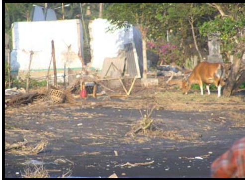
Gambar 2.12b Bangunan penduduk yang terkena abrasi di Pantai Tegal Badeng
